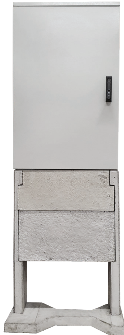
WAVEPACE® Fiber-Cabinet-P2MP mit montiertem Leichtbetonsockel
